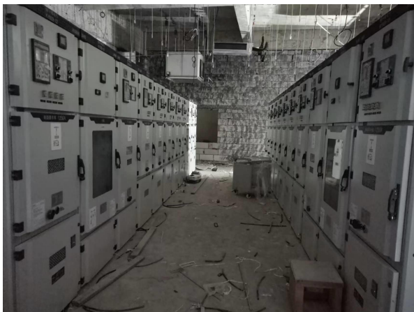
配电房高低压柜安装
