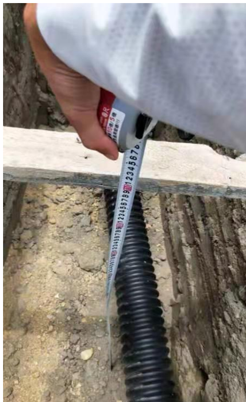
室外电缆保护管
